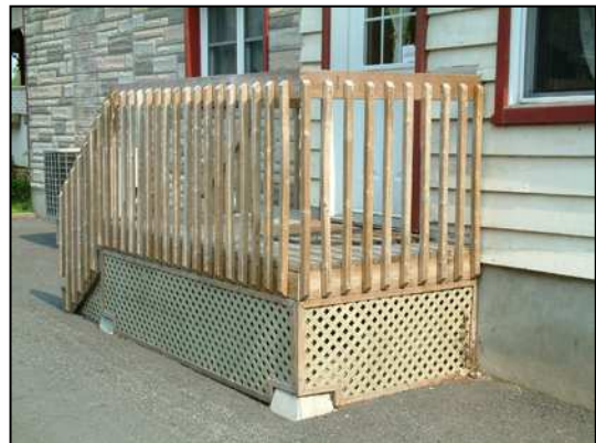
Éviter les garde-corps préfabriqués avec les barreaux fixés aux flancs des mains courantes et de la lisse basse.
