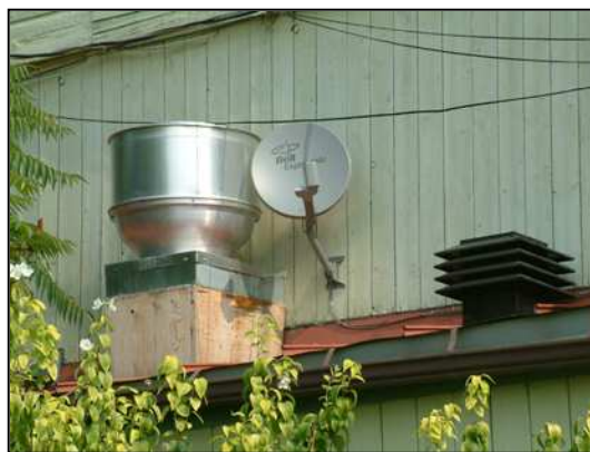
Les éléments discordants comme les équipements mécaniques et les soucoupes devraient être installés à des endroits non visibles de la voie publique.
