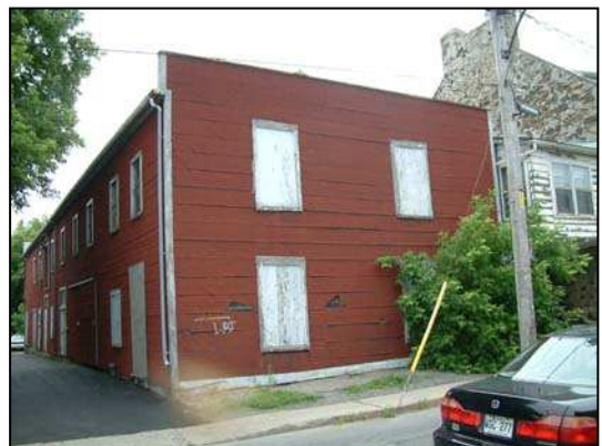
Bâtiment revêtu de papier goudronné imitant la brique. Ce type de matériau peu durable est à proscrire.
