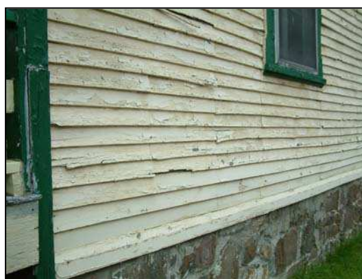
Parement de bois mal entretenu à réparer.
