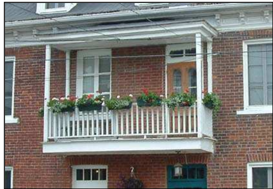
Garde-corps en bois sur un balcon.
