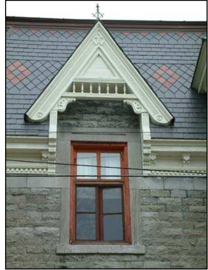
Toiture revêtue d'ardoise. Le découpage et la couleur des bardeaux forment des motifs décoratifs.
