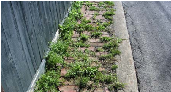
Fig. 81 : Exemple d'espaces résiduels aménagés avec un matériau adéquat mais à l'entretien déficient |
