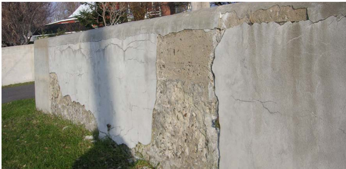
Fig. 12 : Digue à restaurer et à éclairer |
